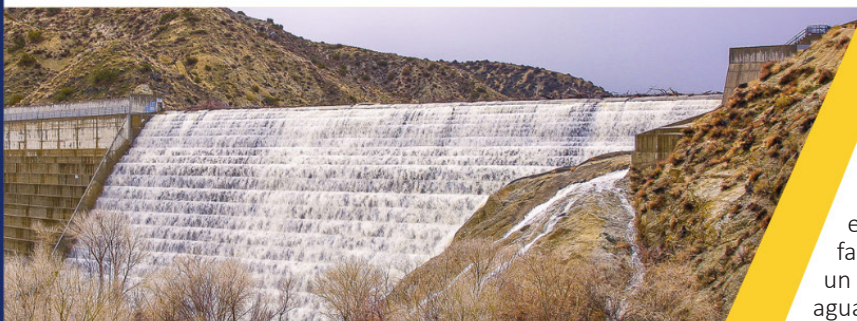
Desbordamiento de la presa de Littlerock tras las fuertes lluvias de Enero.
