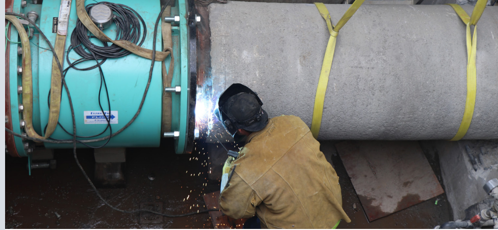
El trabajador principal de servicios, Tony Espinoza Jr., suelda con autógena la nueva tubería para la línea de efluentes.
